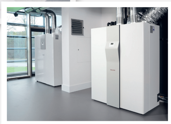
Die Systeme in den Praxisräumen sind in Funktion und unter realen Einsatzbedingungen erleb- und vergleichbar.
